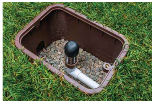
Válvula de Ventosa de Aire/Vacío Instalada
