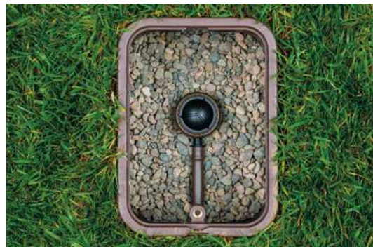
Válvula de Descarga Automática Instalada
